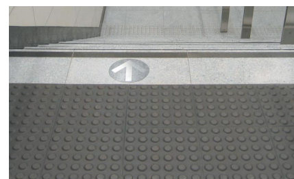
6.9.1c) 在楼梯顶部的警告砖
