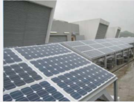
太阳能光伏板供电系统
