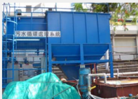
污水循環處理系統
