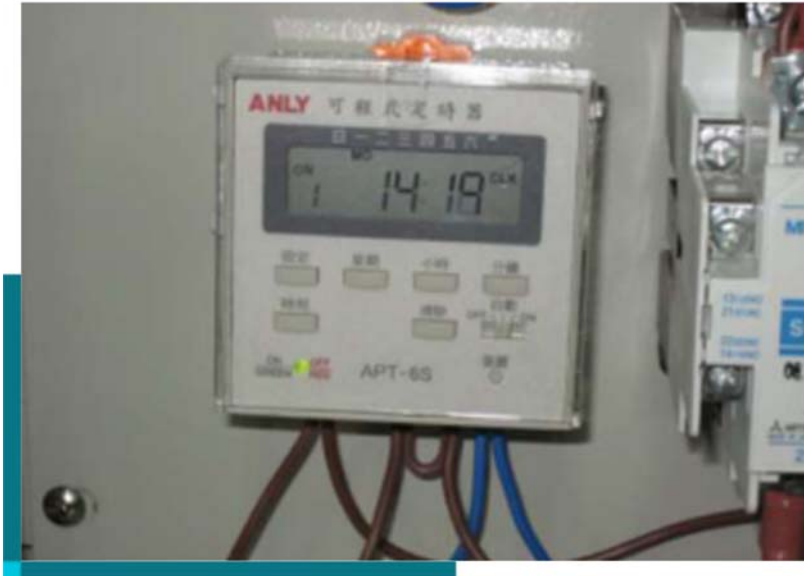
为非必要电插座供电安装定时器控制
