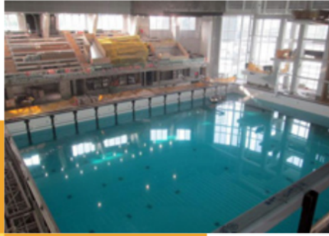
利用回收废水测试泳池及滤水装置系统
