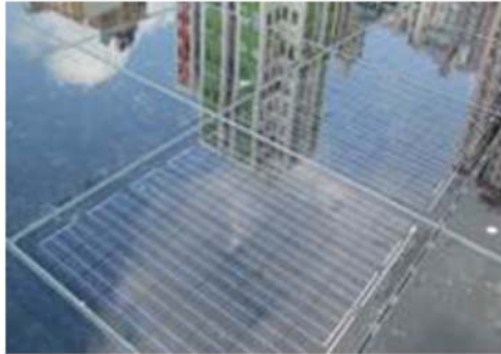
附设于建筑物光伏系统的光伏板
