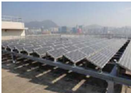
天台太阳能光伏板
