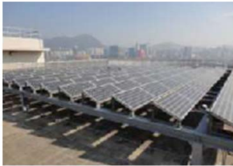
天台太陽能光伏板
