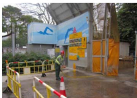
工地入口的噴霧灑水系統
