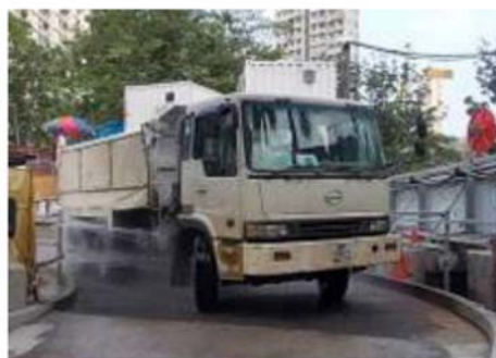
地盤出口的輪胎清洗設施
