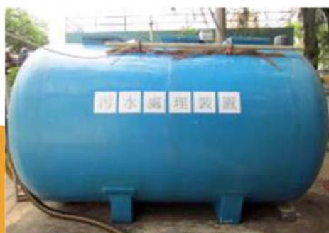
污水處理系統
