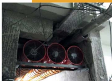
地庫安裝鼓風機加強通風
