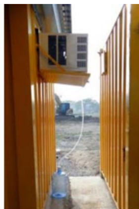
收集空調機滴水循環再用
