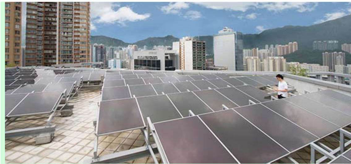
上层天台的太阳能光伏板
