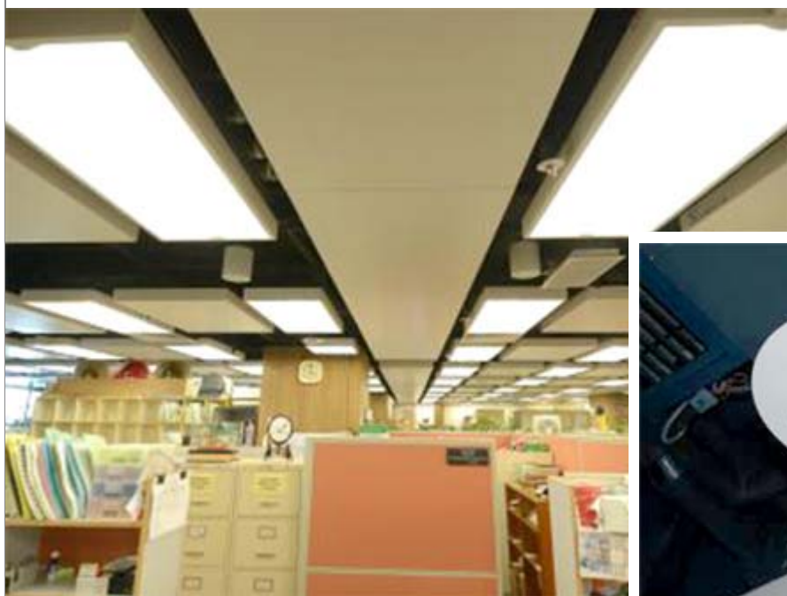
采用辐射冷却板的创新辐射冷却系统
