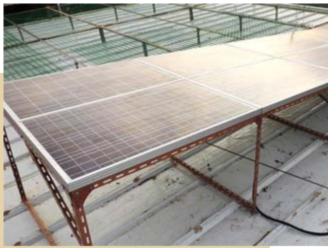
太阳能光伏板 2
