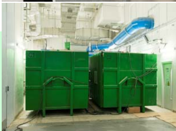
每层均设有废纸及一般废物处置入口槽，地下则有一般废物入口槽(上)，地库设有中央废物收集站(下)
