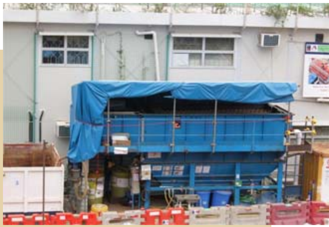
废水处理装置 2
