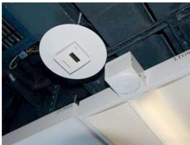
間接LED照明裝置可調暗光度節約能源
