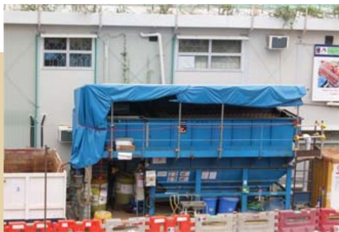
廢水處理裝置 2
