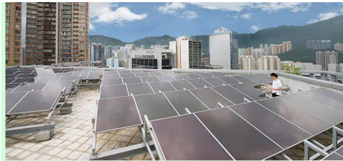
上層天台的太陽能光伏板
