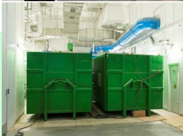
每層均設有廢紙及一般廢物處置入口槽，地下則有一般廢物入口槽(上)，地庫設有中央廢物收集站(下)
