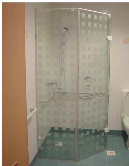
6.11.6c) 在长者宿舍内，装有防水紧急拉绳警报及扶手的淋浴间
