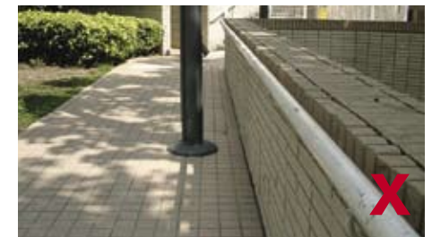
3.1.2.4d 燈柱阻礙通道，危害使用者安全，尤其是使用扶手的人士
