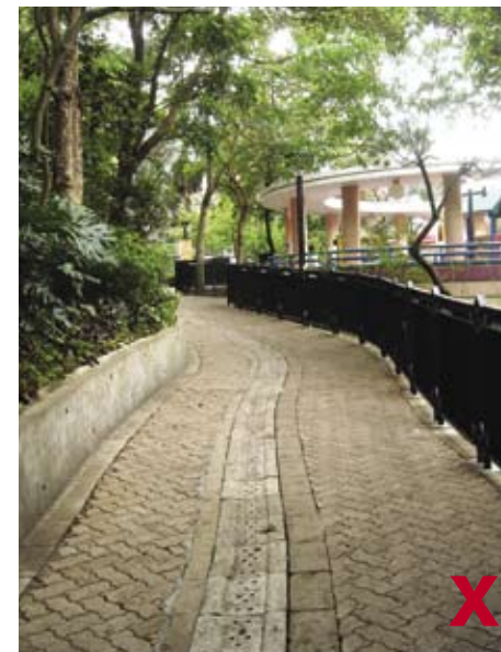
3.1.4.2d 排水渠應與毗連地面齊平。行人道中央凹凸不平，危害途人安全
