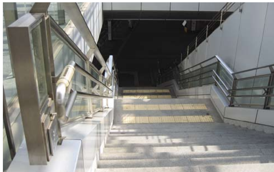
3.1.6.1d 樓梯兩端設有觸覺警示帶，兩旁設有扶手，扶手橫向延伸部分設有點字
