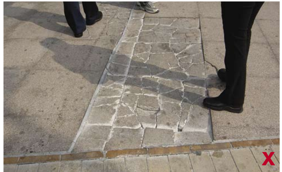
3.10.2a 損毀的地方應妥善圍封，行人徑應妥為改道
