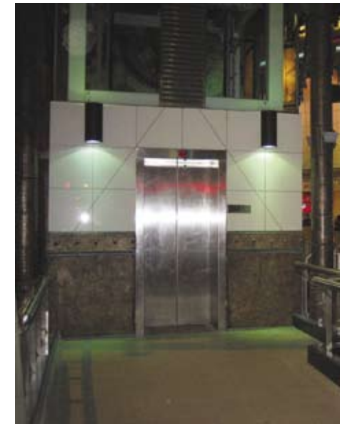
3.8.1.3d 除行人徑的照明裝置外，在通往行人天橋的升降機入口加設掛牆燈
