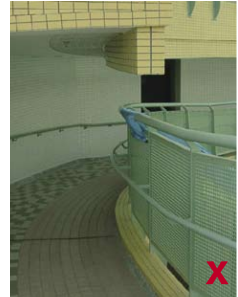
3.9.2.1h 護欄上高架結構令通行高度過低
