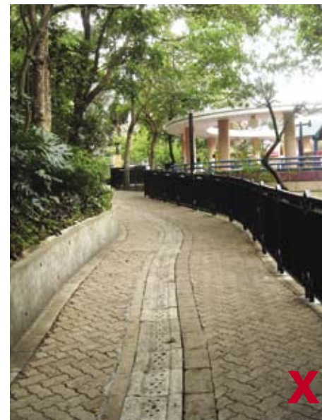
3.1.4.2d 排水渠应与毗连地面齐平。行人道中央凹凸不平，危害途人安全
