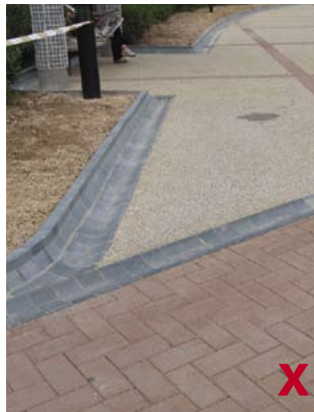
3.1.4.2c 路上的无盖排水渠危害途人安全，应该避免
