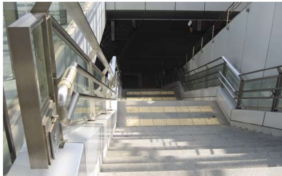
3.1.6.1d 楼梯两端设有触觉警示带，两旁设有扶手，扶手横向延伸部分设有盲文
