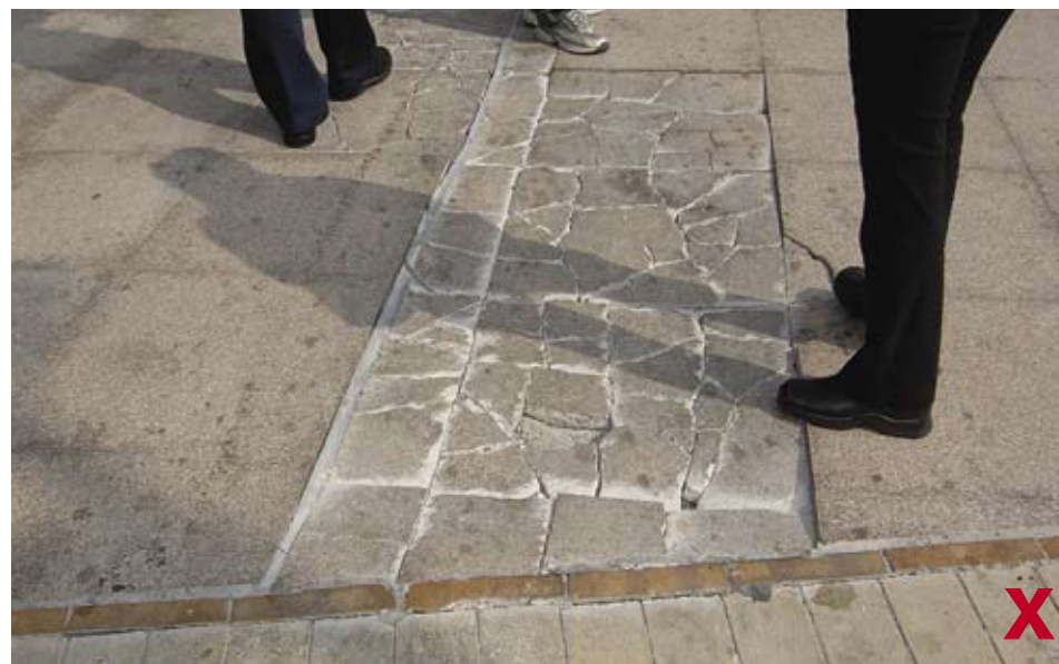
3.10.2a 损毁的地方应妥善围封，行人径应妥为改道
