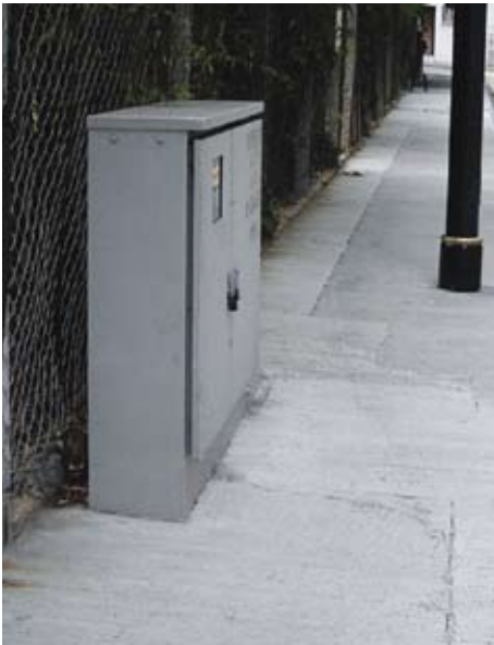
3.4.5.1b 行人径旁的公用设施控制箱
