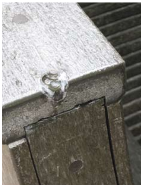
3.4.2.4q 正如其他公众设施，儿童游乐设备往往易遭恶意破坏，必须妥善保养和管理
