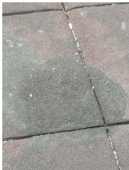
3.4.3.2i 破烂地垫须从速更换
