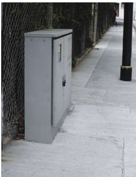
3.4.5.1b 行人径旁的公用设施控制箱
