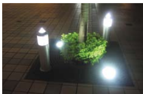
3.8.1.1d 树槽的地灯及矮灯
