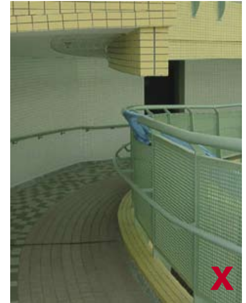
3.9.2.1h 护栏上高架结构令通行高度过低
