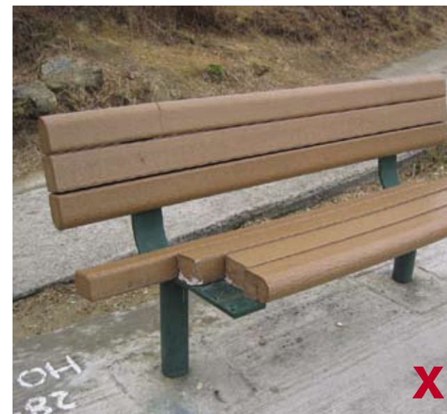
3.9.5a 设施日久失修，可能会无法使用或构成危险
