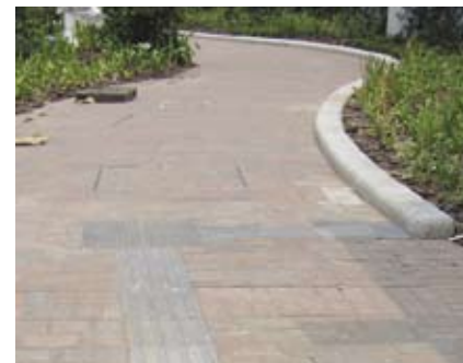
4.6m 可感应面由触觉引路带变为路缘石，应充分提醒使用者感应提示的变换
