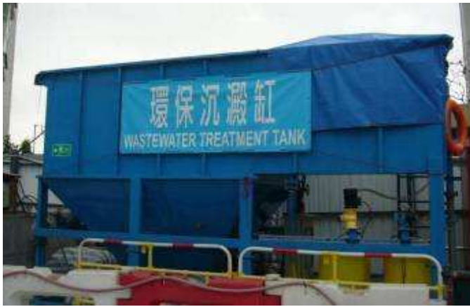
圖 8. 污水處理系統(環保沉澱缸)
