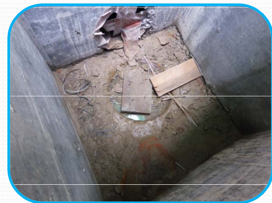
沙井隔氣渠位積水
