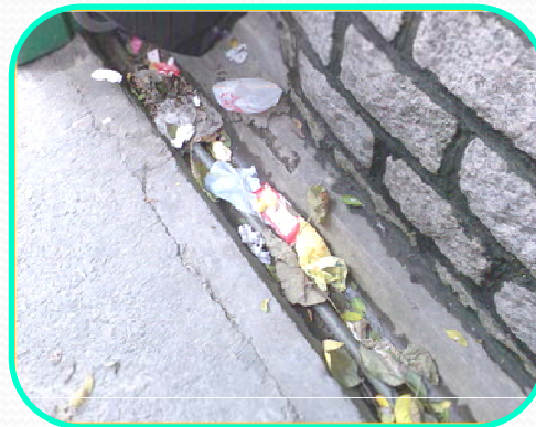
去水渠堵塞積水
