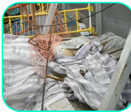
帆布縐摺積水
