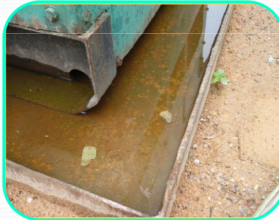
發電機底盤積水
