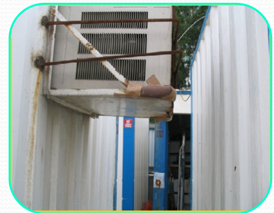
冷氣機底盤積水
