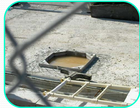
井蓋凹位積水
