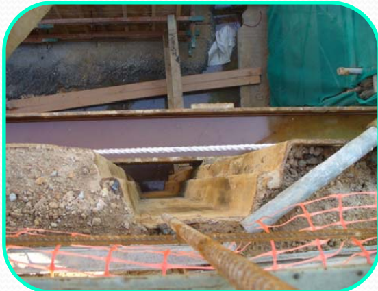
工字鐵橫撐凹位積水
