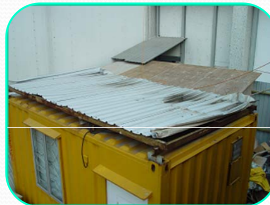
貨櫃頂不平蓋板積水
