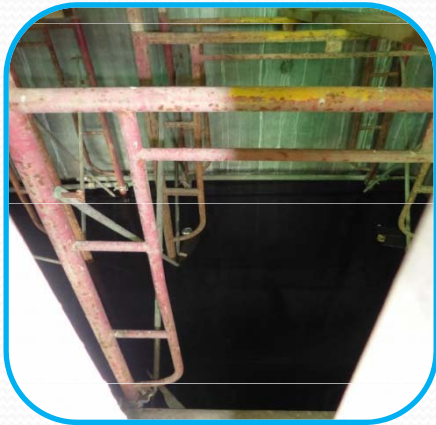
升降機槽底積水
